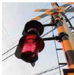
全方向踏切警報灯 東員7号踏切
